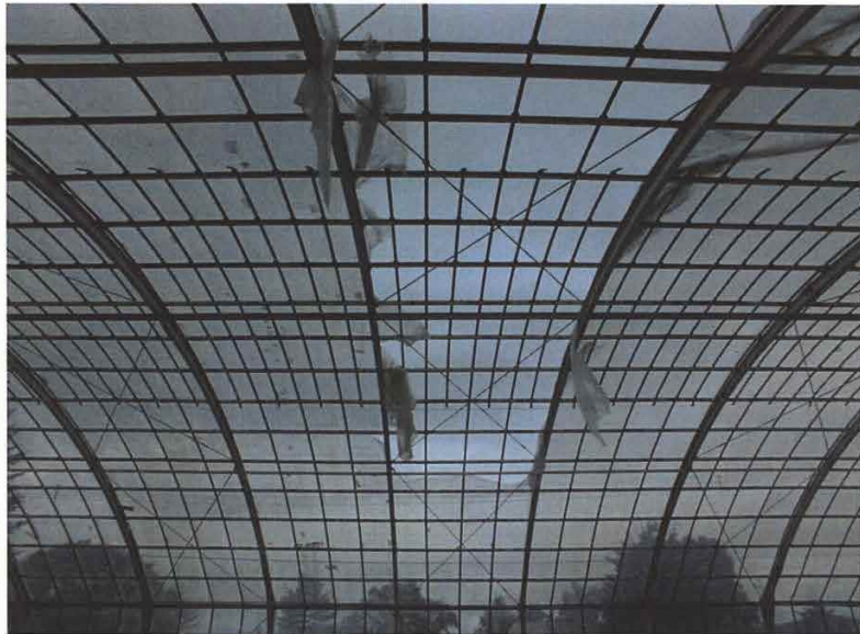
NO. 1 破損状況 (全景)
