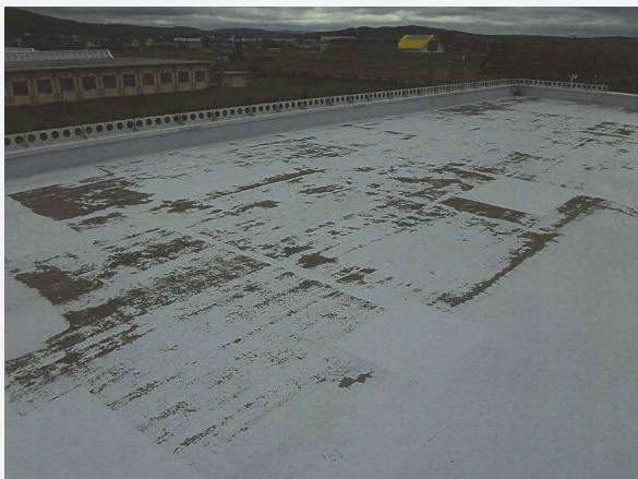
〈修理前③〉剥離している？
