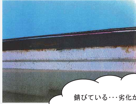
〈罹災状況②〉
