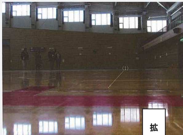
〈罹災状況⑥〉 横からのアングル で段差を確認
