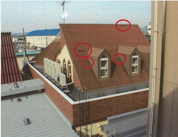
〈写真①〉 修理前
