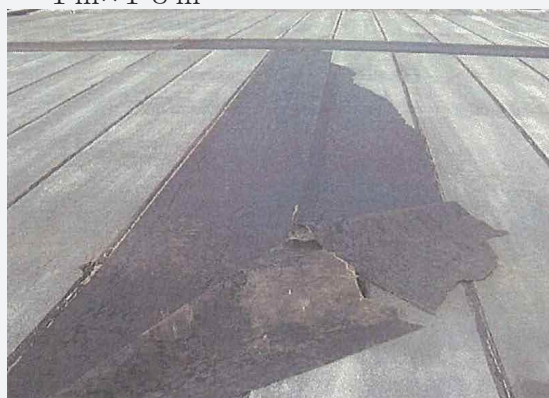
〈写真④〉 修理前
