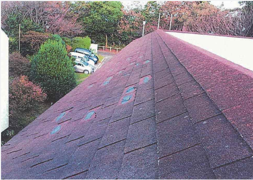
〈罹災状況①〉
