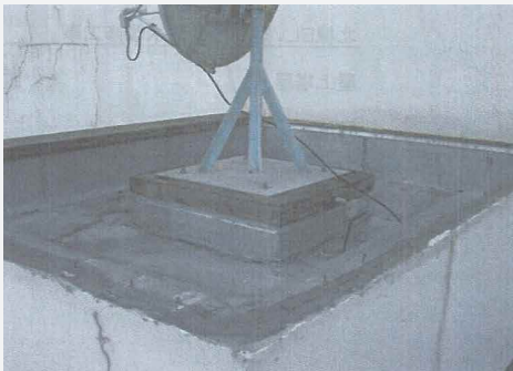
〈修理前〉 一部の笠木が剥がれている
