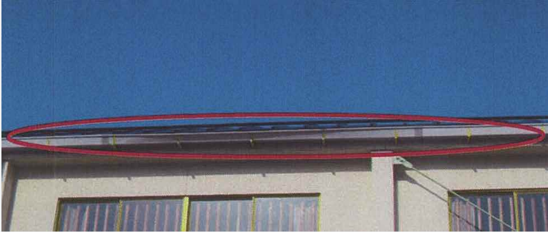
〈修理前〉黄色い取付金具しかない。
