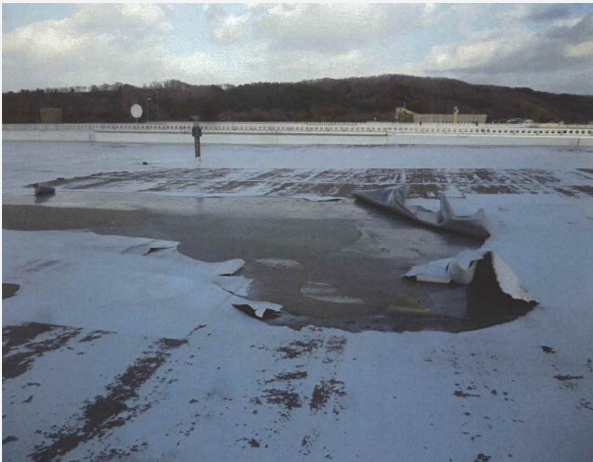
〈修理前①〉剥離が確認できる。
