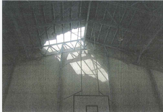
〈罹災状況②〉 体育館の中に、穴から光が差している。
