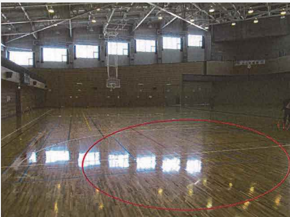
〈罹災状況①〉 赤囲みの中が水損箇所
