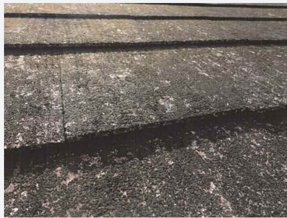
〈写真⑩〉屋根の反り（経年による）
