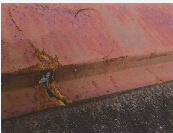
〈写真⑦〉 棟板金の傷み
