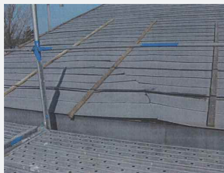
〈罹災状況③〉仮おさえ
