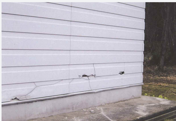
〈写真①〉 修理前
