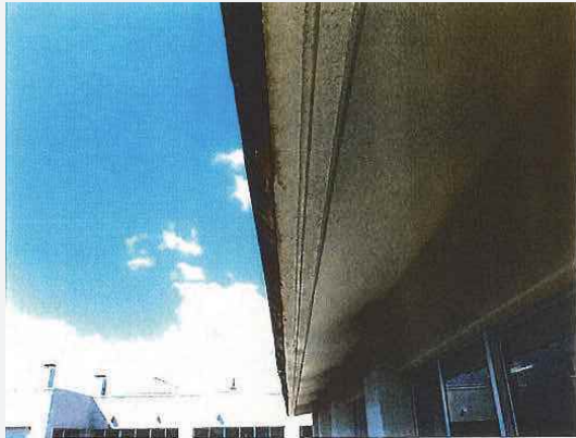
〈罹災状況①〉
