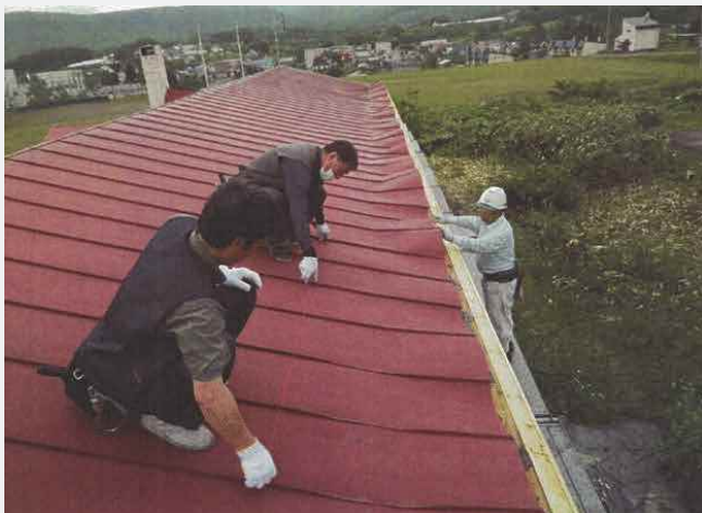
〈修理中②〉 貼り替え部既存撤去 損害箇所のみ剥がしている。
