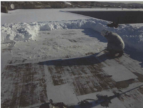
〈修理前②〉剥離している？
