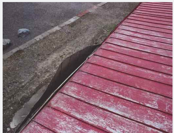
〈罹災状況②〉
