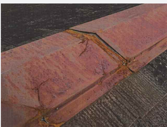
〈写真⑧〉 棟板金の傷み
