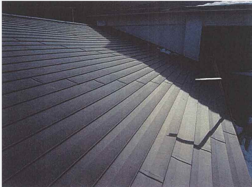
〈修理後〉コーキングで屋根を修繕した後に、雪止めを再設置。
