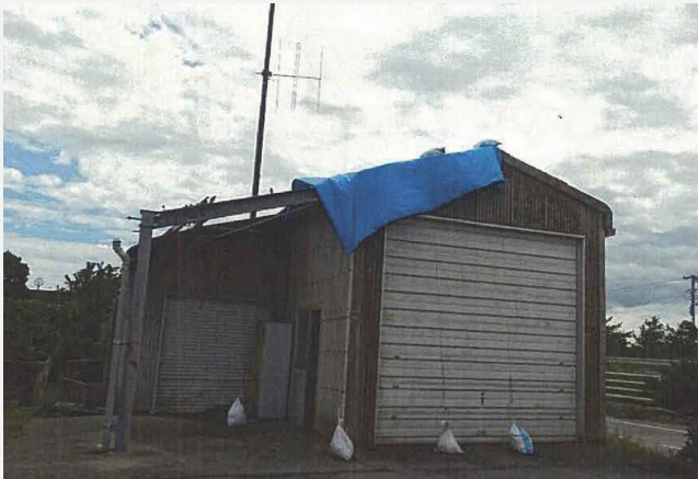
〈修理前①〉 罹災建物
