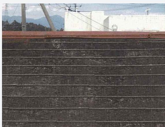
〈写真⑥〉 棟板金の傷み
