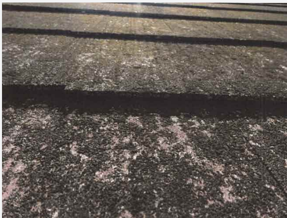
〈写真⑨〉屋根の反り（経年による）
