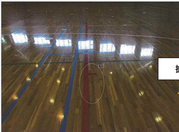
〈罹災状況③〉 (1) が板に開きがある箇所
