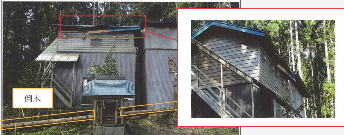
罹災状況写真
