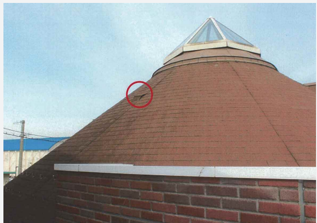
〈写真④〉 修理前
