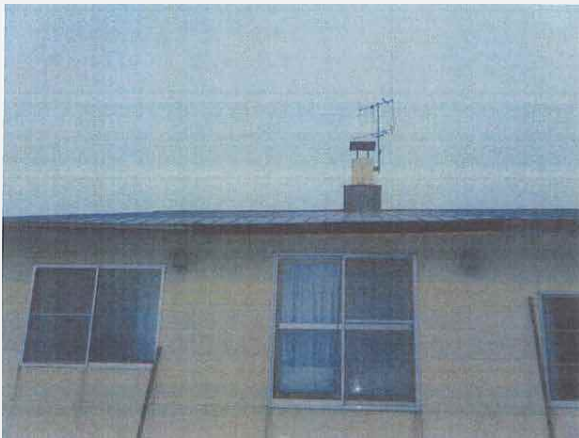
〈修理前〉 軒先が歪んでいる。
