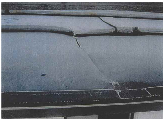
〈拡大②〉 屋根の破損
