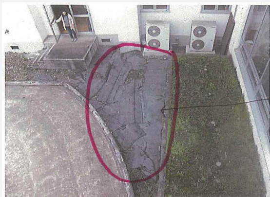
〈写真①〉 修理前
