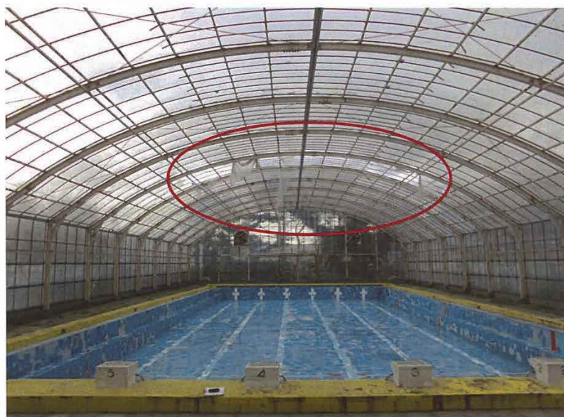
NO. 2 破損状況
