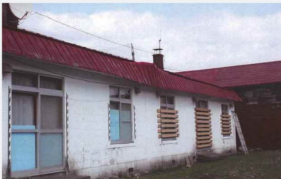
〈罹災状況①〉
