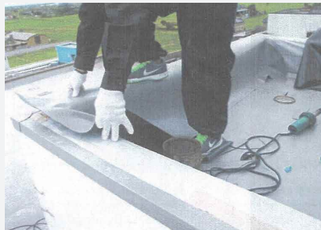
〈修理中〉 笠木部分に防水シート？
