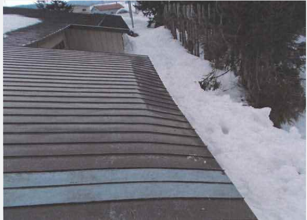
〈修理前〉 屋根が潰れていることが確認できる
