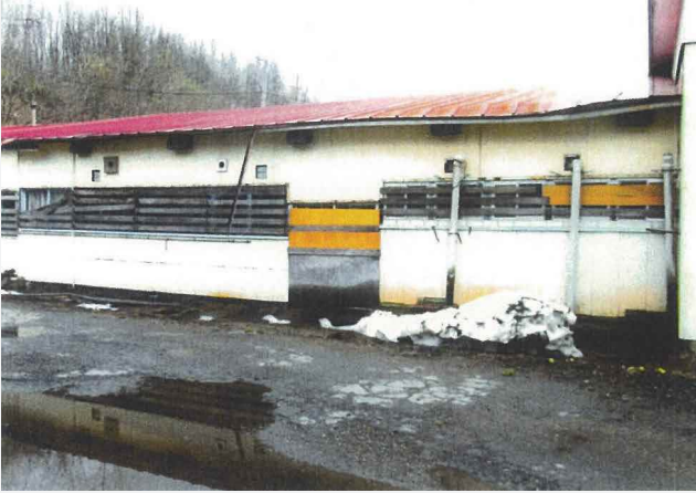
〈罹災状況〉 軒先の破損が確認できる。
