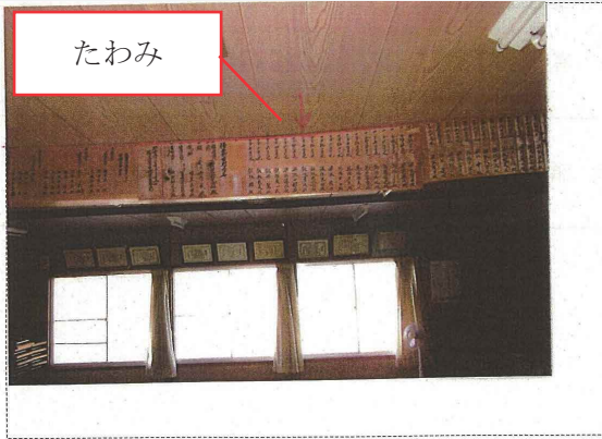
平成 27 年 10 月 14 日 測点 2F 会議室 工事概要 小屋梁のたわみ状況 (室内より)
