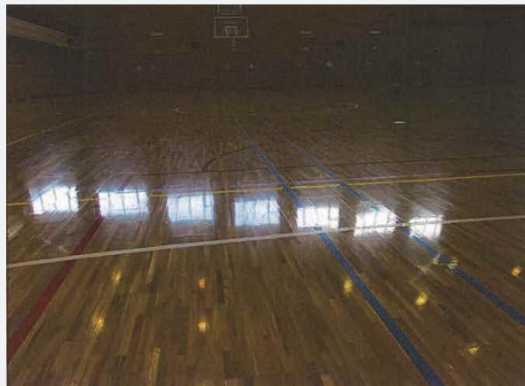
〈罹災状況②〉 光の当たっている部分が水損箇所
