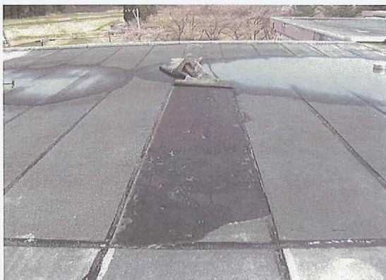
〈写真②〉 修理前
