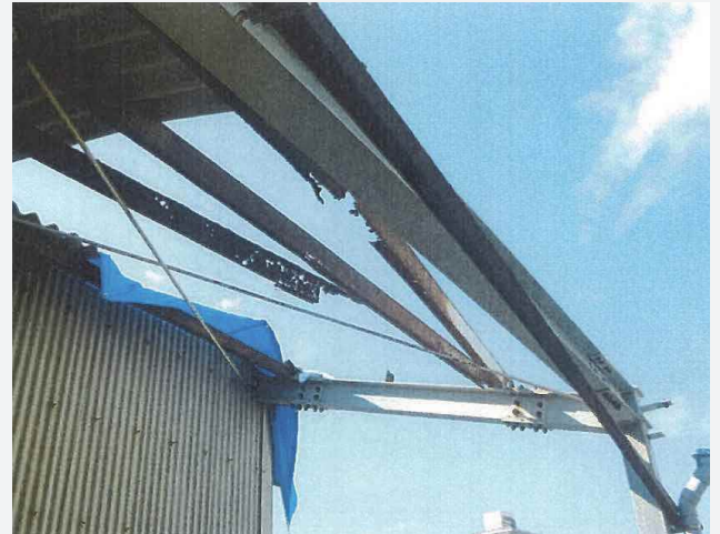
〈修理前③〉 風害??
