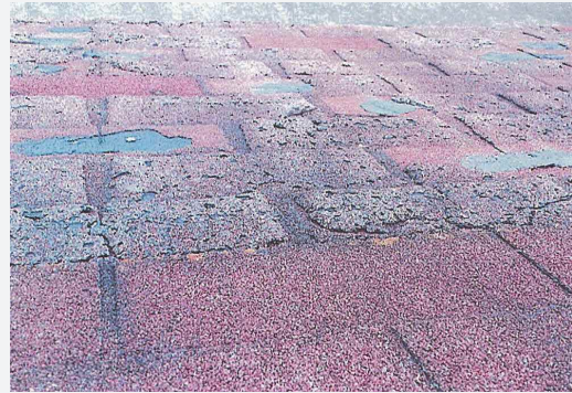
〈罹災状況②〉
