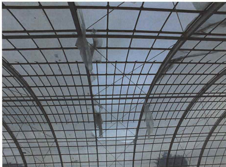
NO. 2 破損状況 (全景)
