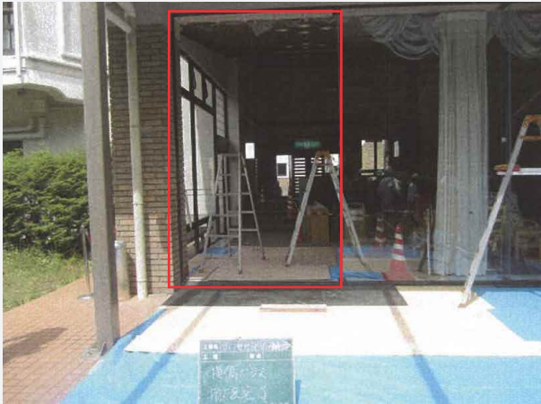
〈罹災状況〉赤枠部分のガラスが破損した。
