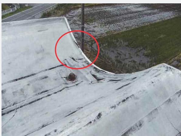
〈修理前②〉赤丸部分がめくれている
