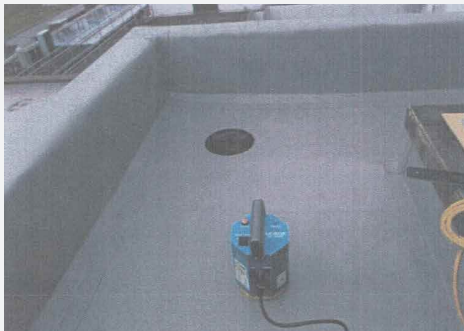
〈修理後〉 原状復旧ではない??
