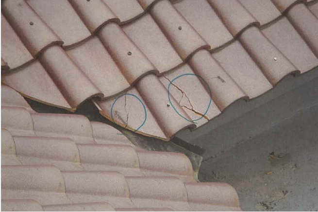
〈修理前④〉破損状況が確認できる。
