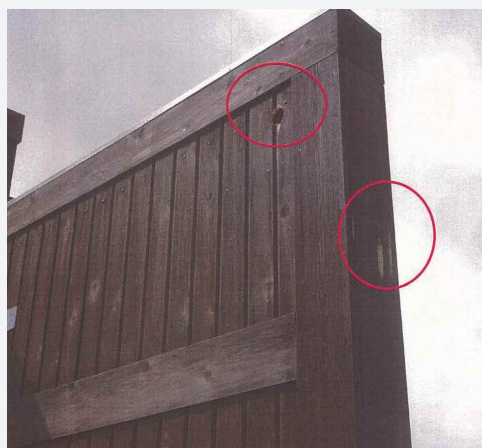
〈写真②〉 修理前
