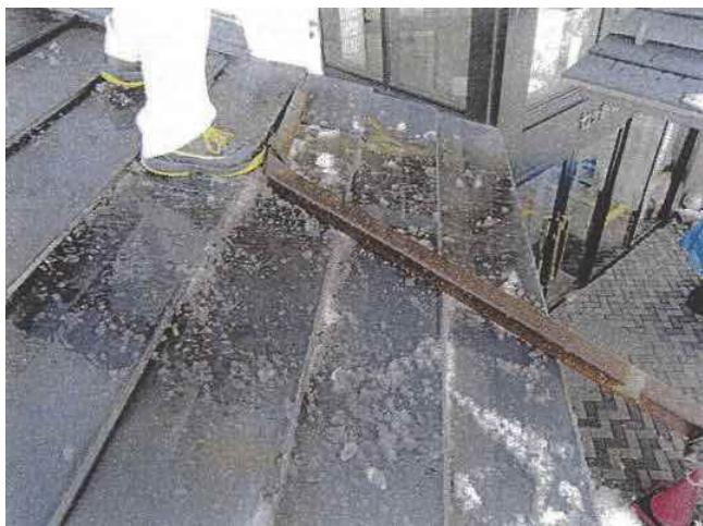
〈拡大①〉 雪止めの破損
