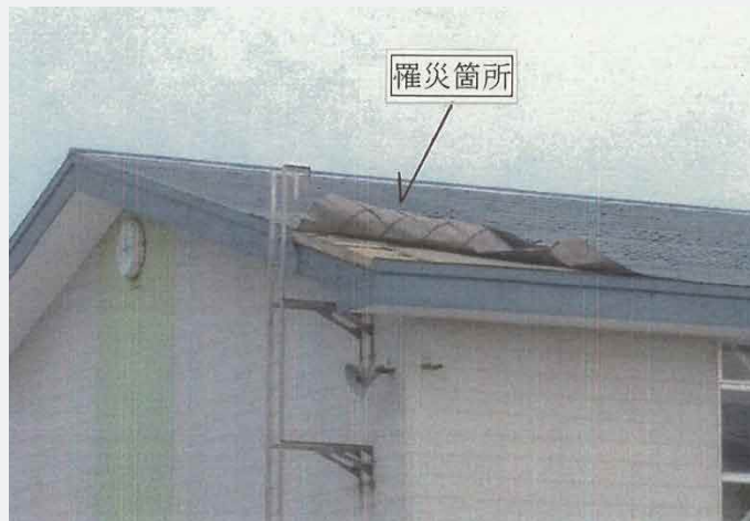
〈罹災状況①〉
