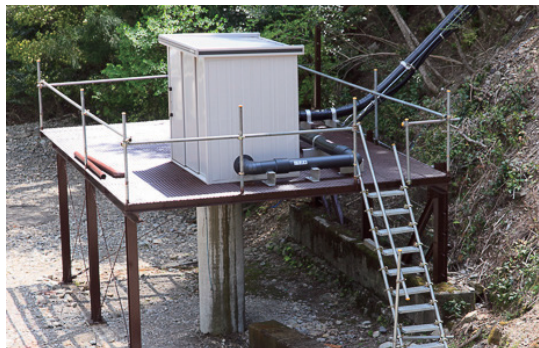
〈源泉ポンプの例〉
